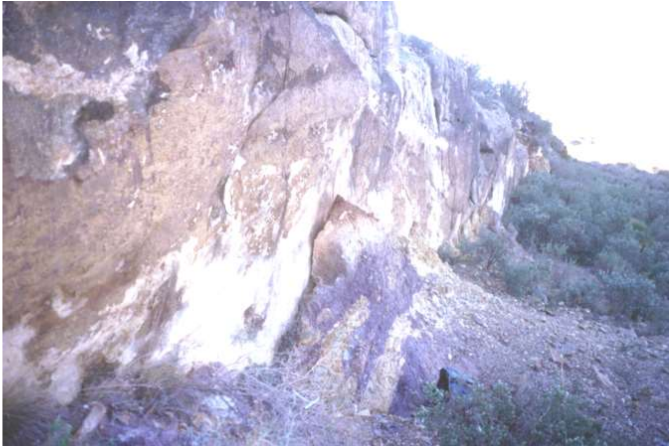
27-39-IN-FG-F 77.- Plano de Falla afectando a los carbonatos de la unidad de Cabo Tiñoso.
